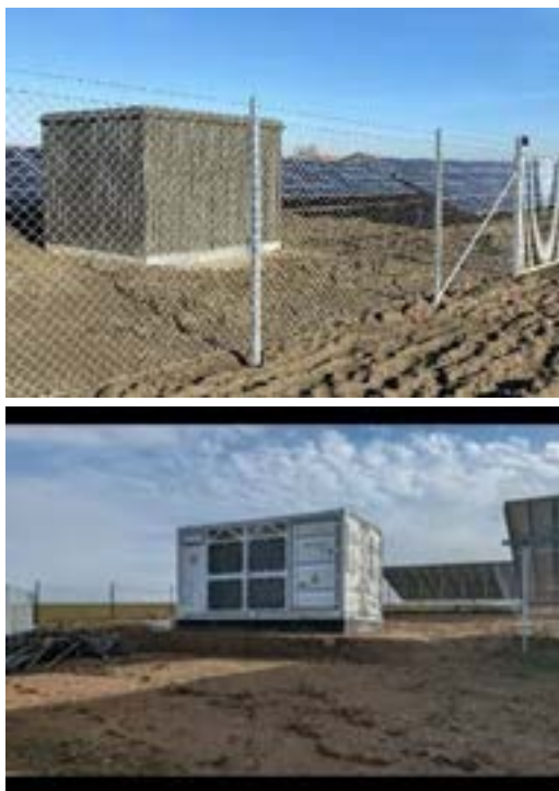
Figur 8. Eksempel på parktransformer.
